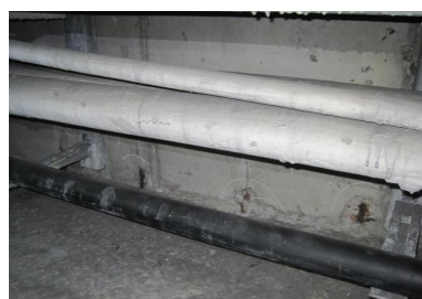
오금로 상수,통신구 철근노출
